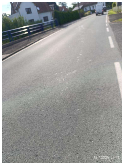
Stav krytu vozovky na mostě
