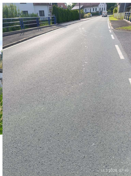
Stav krytu vozovky na mostě (1)
