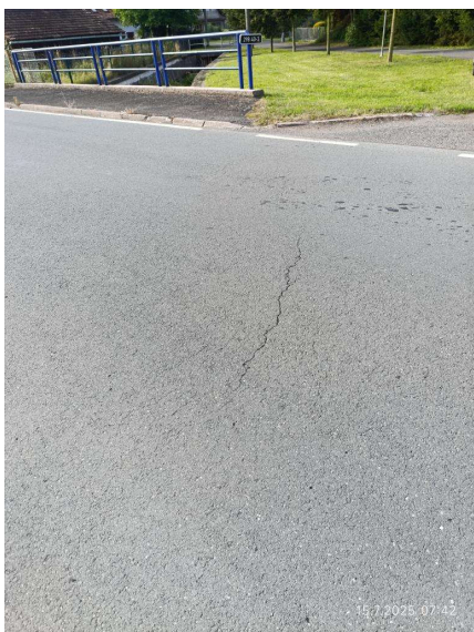
Stav krytu vozovky na mostě (2)
