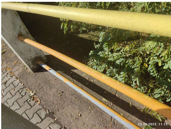
Stav nátěru levého zábradlí_
