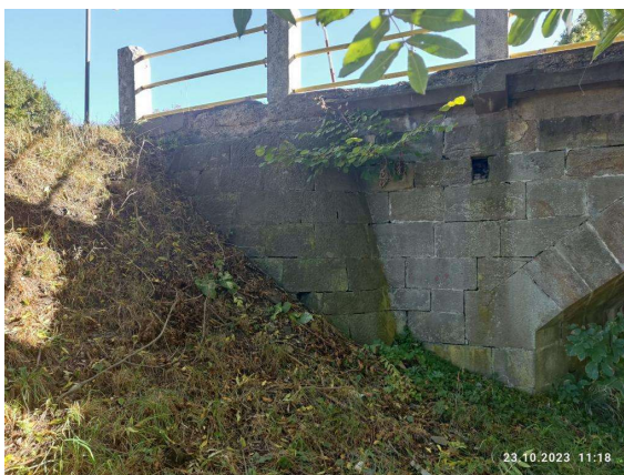
Levé křídlo na konci mostu (K3)
