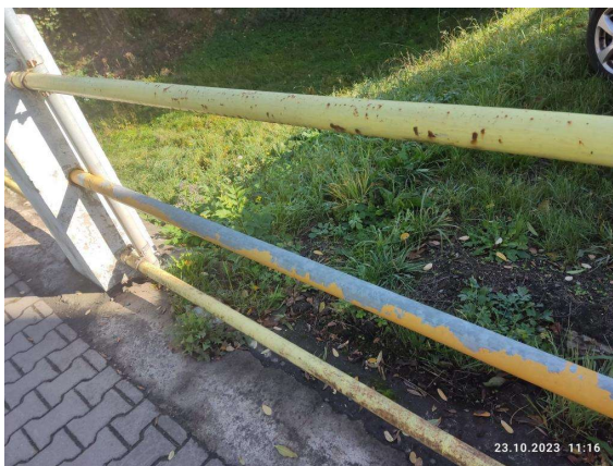
Stav nátěru pravého zábradlí
