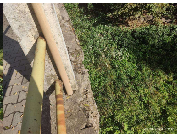
Stav horní plochy pravé římsy
