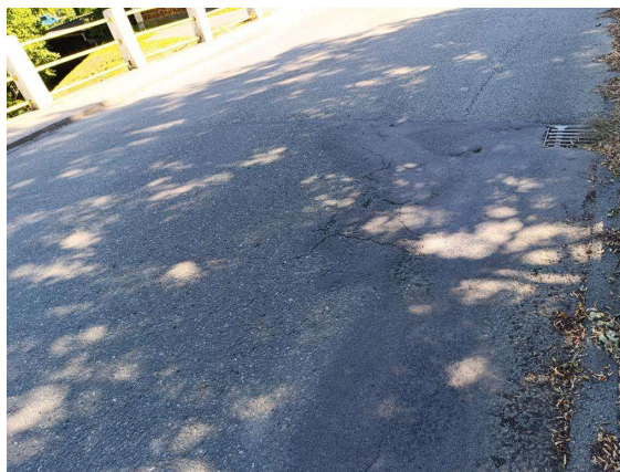
Stav krytu vozovky na mostě (3)
