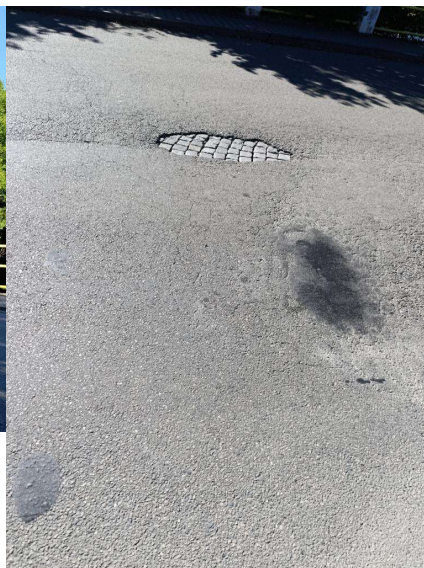
Stav krytu vozovky na mostě (1)
