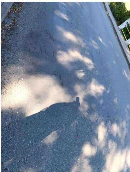
Stav krytu vozovky na mostě (4)
