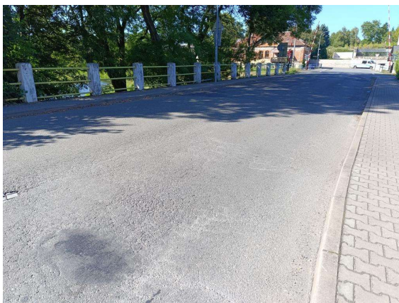
Stav krytu vozovky na mostě
