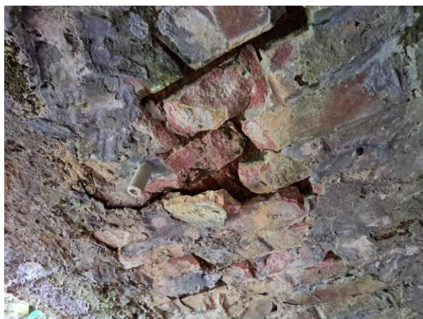
Detail trhliny_pohled klenby_povodní strana
