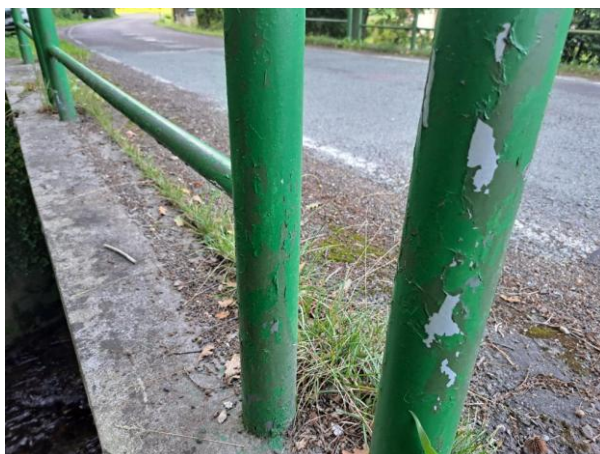
Poruchy PKO zábradlí_návodní strana
