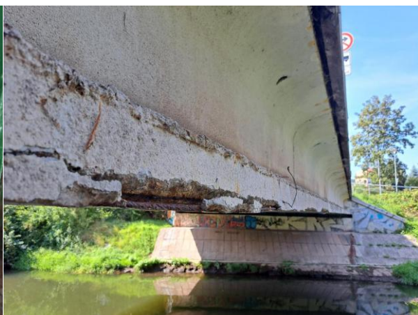
Krajní nosník_návodní strana_obnažená a korodující výztuž
