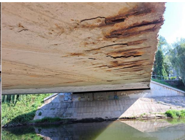
Obnažená a korodující výztuž_krajní nosník_povodní strana
