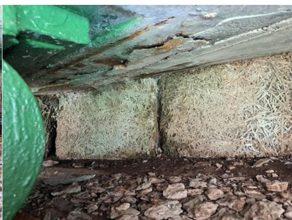
Závěrná zídka OP2_vlhké stopy po zatékání vody
