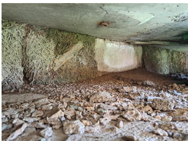
Závěrná zídka OP2_vlhké stopy po zatékání vody
