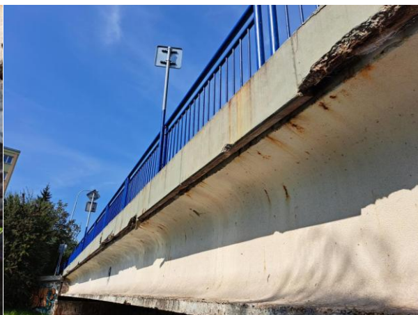
Krajní nosník_povodní strana_degradace římsovek při spodním líci
