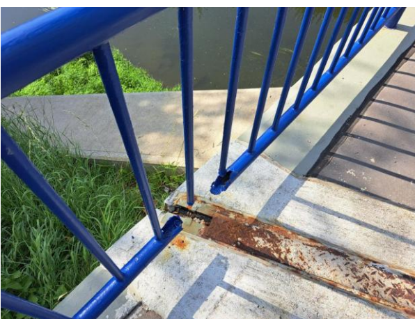
Detail koroze zábradlí_MZ nad OP2_povodní strana
