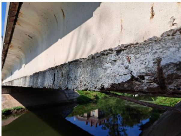
Krajní nosník_povodní strana_detail obnažené výztuže
