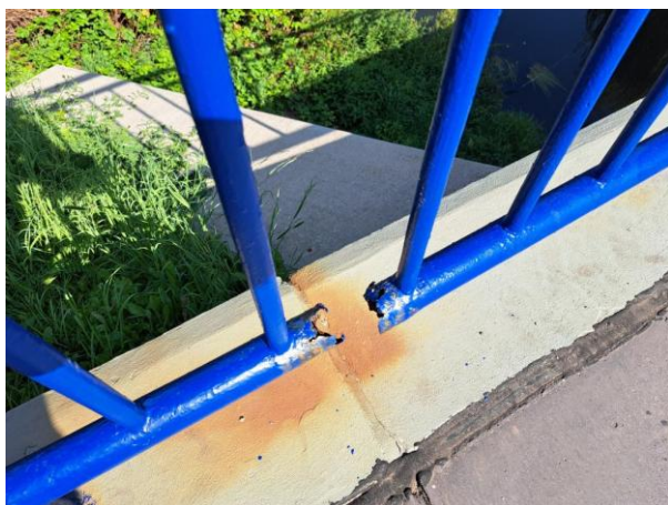
Porucha zábradlí_ návodní strana nad OP1
