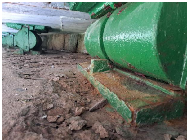
Ložiska na OP2_počínající koroze
