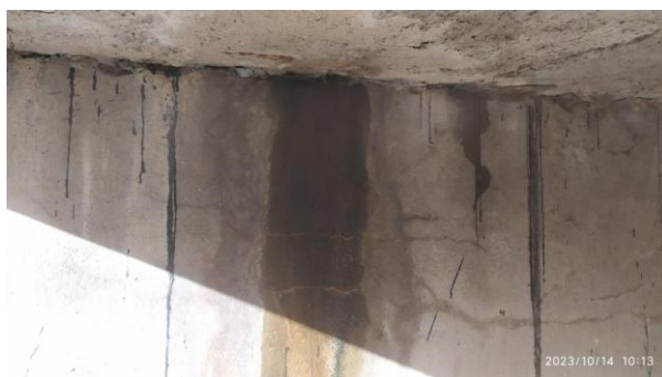
Zatékání na OP1
