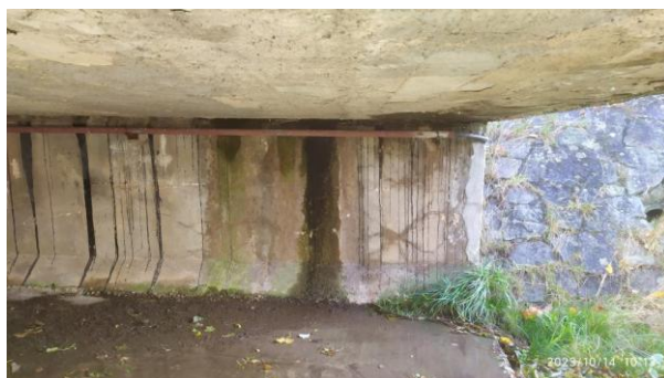
Zatékání na OP2
