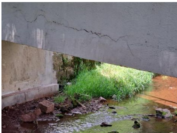
trhlina_krajní nosník_pravá strana
