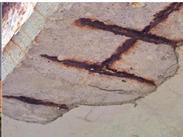
obnažená a korodující výztuž_krajní nosník_pravá strana
