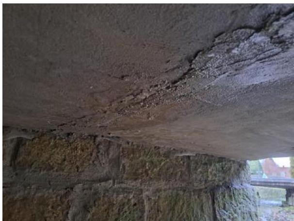
průsaky vody na podhledu_okraj nosné konstrukce z návodní strany
