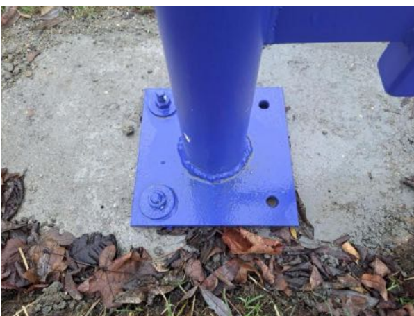
chybějící šrouby kotvení patky zábradlí
