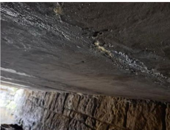
podhled nosné konstrukce_průsaky_levé polovina mostu
