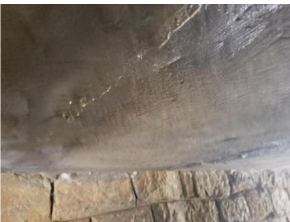
průsaky vody na podhledu_poruchy hydroizolace_levá polovina mostu
