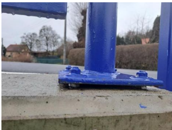
absence podmazání patky zábradlí plastmaltou
