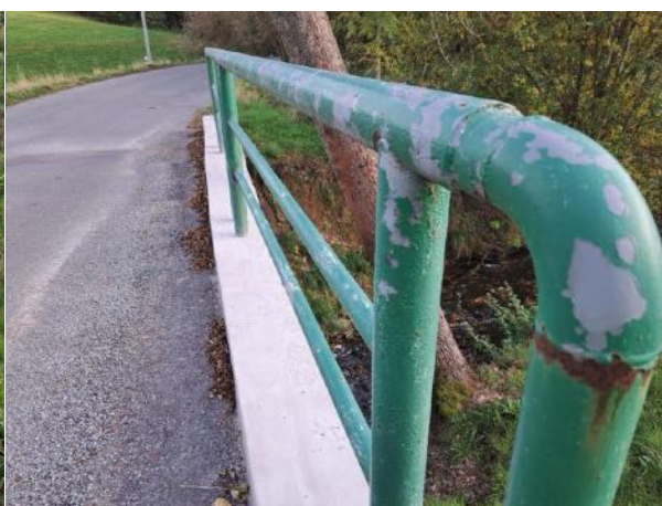
poruchy PKO zábradlí_povodní strana
