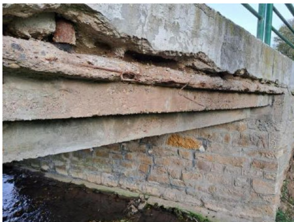
líc římasy a nosné konstrukce_povodní strana_degradace
