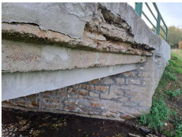
míc nosné konstrukce a římsa_návodní strana_degradace
