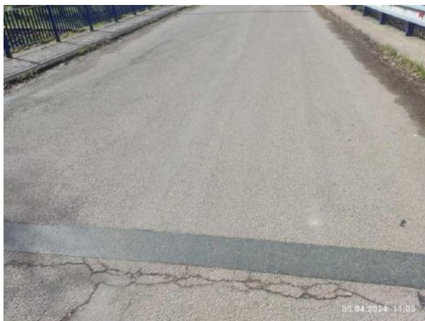
Stav krytu vozovky na mostě
