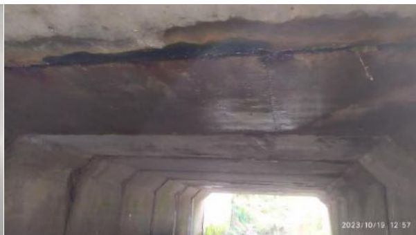
Silné zatékání do NK vlevo
