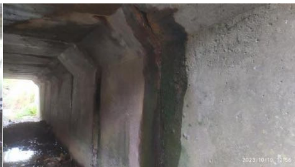
Zatékání na OP1
