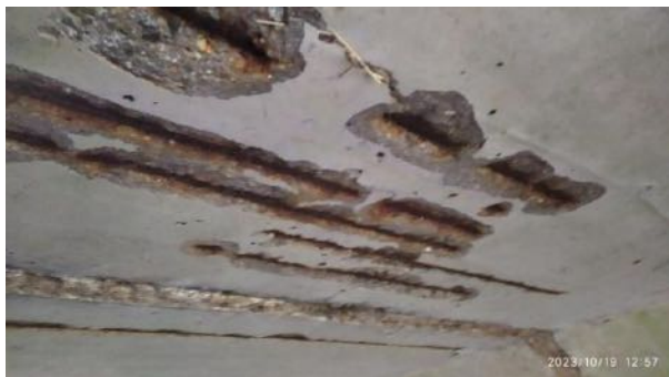
Obnažená korodující výztuž na podhledu BR
