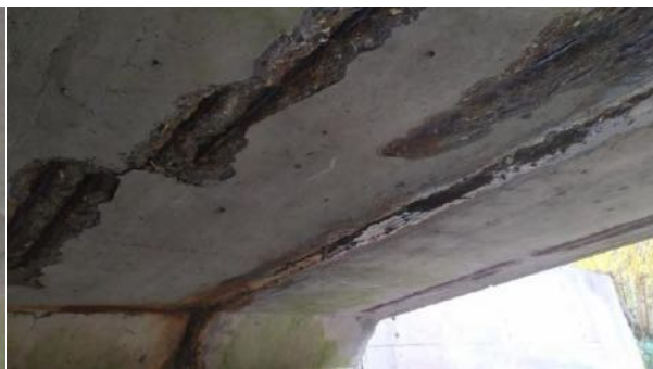
Obnažená výztuž na podhledu BR
