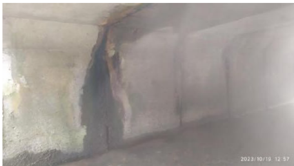
Zatékání na OP2
