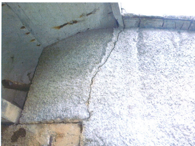
trhlina na konci vpravo
