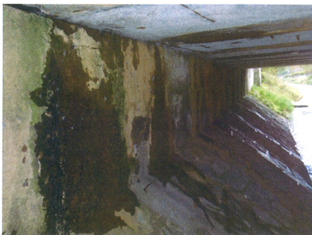
průsaky opěrou na začátku mostu
