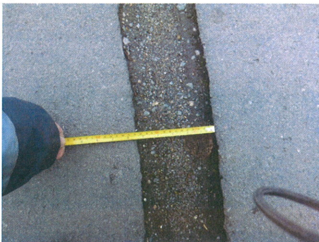
šířka trhliny v krytu chodníku
