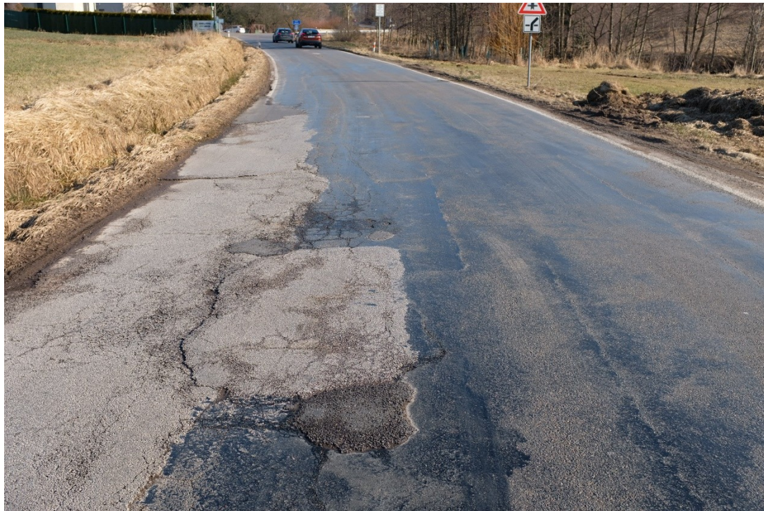
F40 – km 3,050+; havarijní stav před koncem úseku v km 3,155
