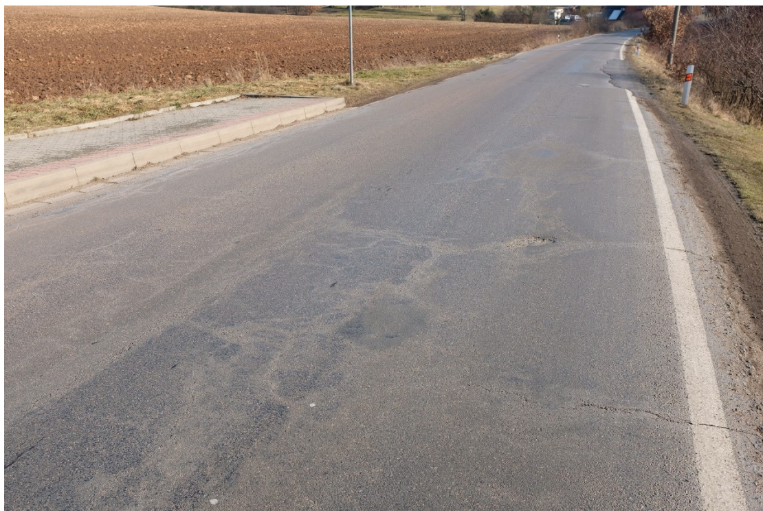
F11 – km 2,308+; různé trhliny, povrchové opotřebení, deformace krytu, vysprávkky
