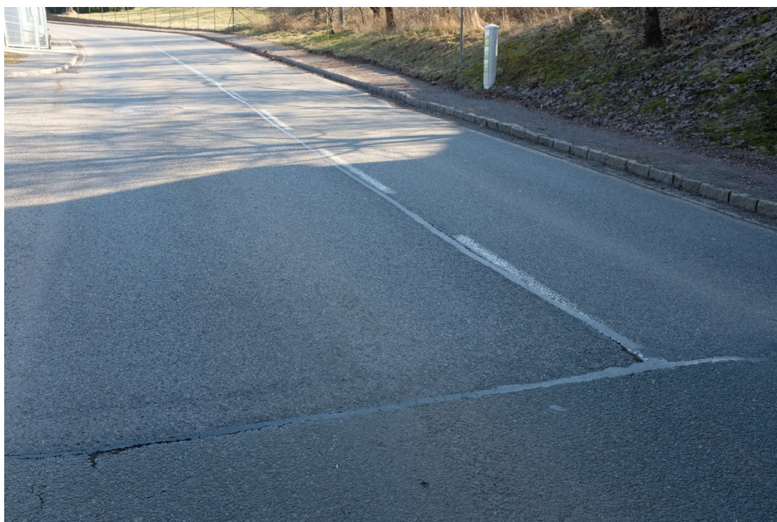
F01 – začátek úseku (ZÚ) – km 2,060; pracovní spára
