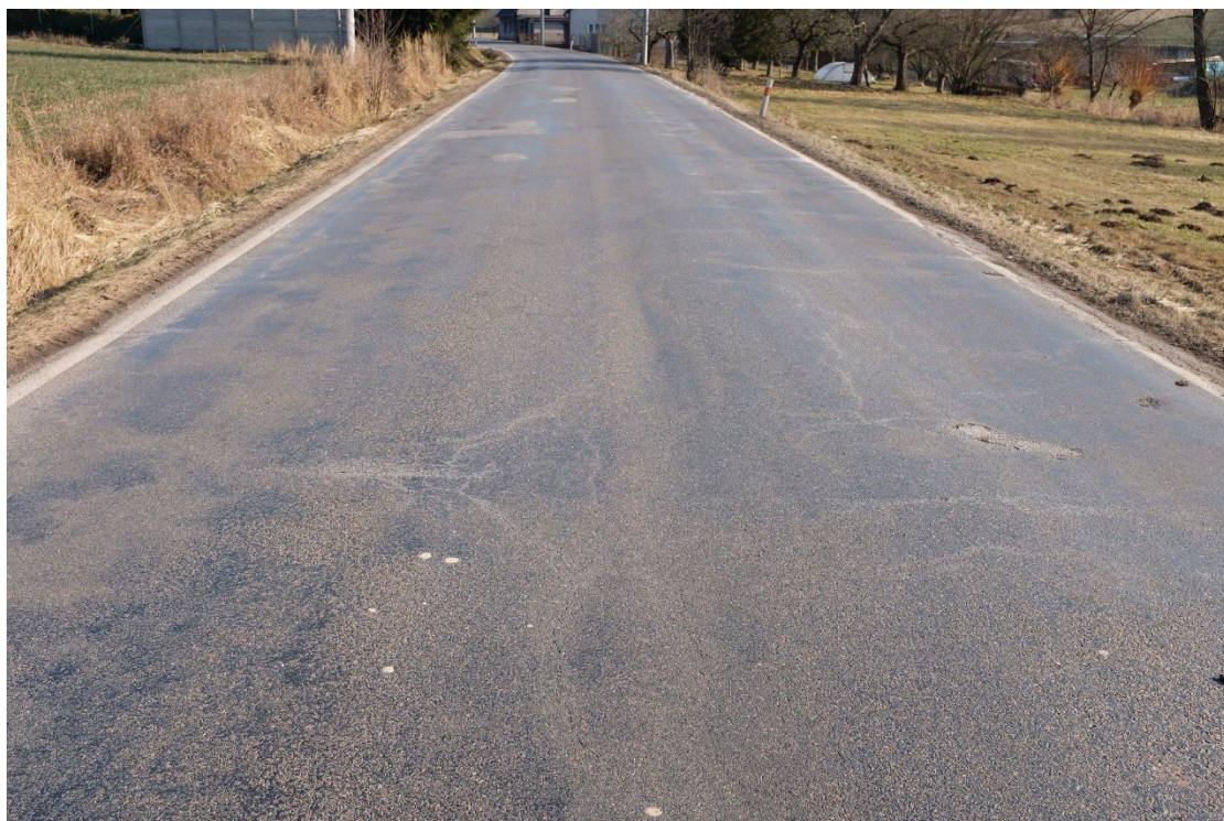
F26 – km 2,700+; různé trhliny, povrchové opotřebení (ztráta nátěru, ohlazení zrn)
