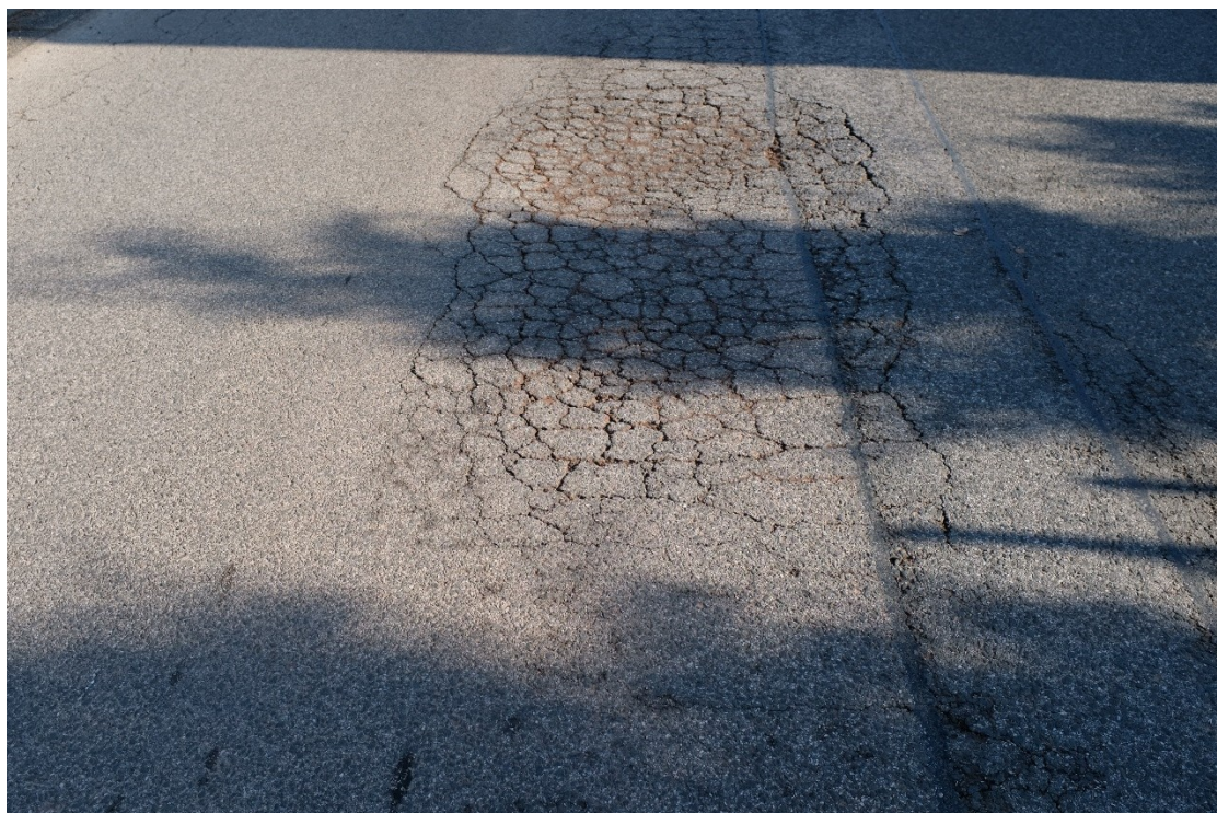
F04 – km 2,150+; lokální síťové trhliny s propadem povrchu vozovky - havarijný stav
