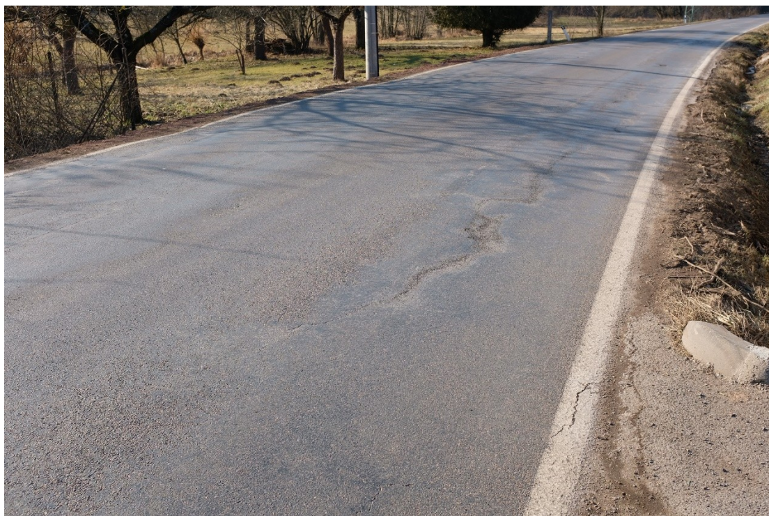
F31 – km 2,800-; podélná široká trhlina, deformace krytu, poklesy u okrajů (vlevo)
