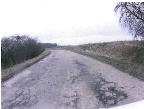
Hl. koroze, výtluky, mozaikové trhliny, vysprávk
