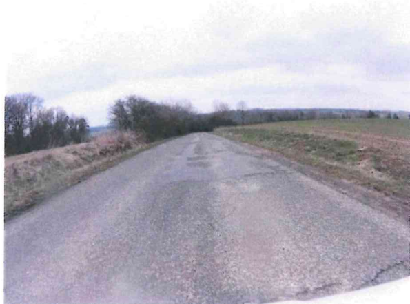
Hl. koroze, mozaikové trhliny, vysprávk, olamování okr.
