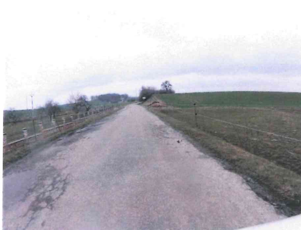
Hl. koroze, mozaikové trhliny, výtluky, vysprávk
