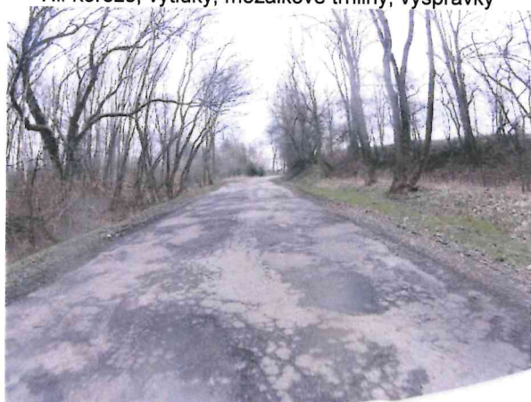
Hl. koroze, síťové trhliny, vysprávk, plošná deformace
