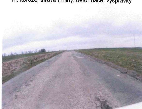
Hl. koroze, zvýšené nepevněné krajnice, mozaik. trhliny
