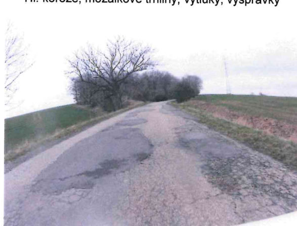
Hl. koroze, síťové trhliny, deformace, vysprávk
