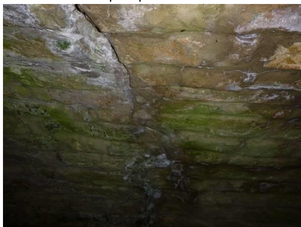
Detailní pohled na trhlínu, kde dochází k zatékání.
