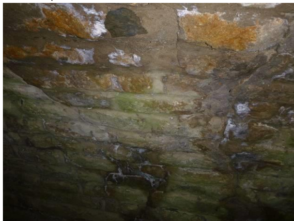
Celoplošně dochází v konstrukci klenby k zatékání.
