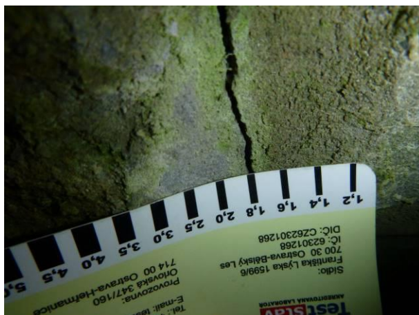
Detailní pohled na trhlínu.
