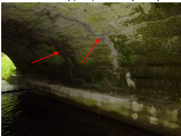
Pohled na levou stranu klenby. Viditelné trhliny ve zdivu.
