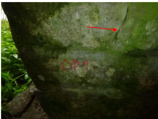
Pohled na pravou stranu, strana vtoku. Šikmá trhlina.
