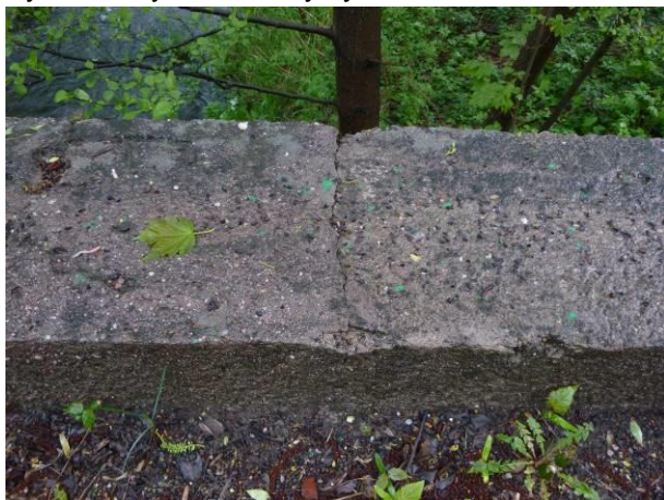
Na několika místech byla detekována v příčném směru trhlina.
