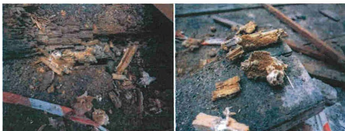
Obr. 4 Fotodokumentace: ložisko dřevokazné houby rodu trametes (outkovka) v aktivní fázi vývojového cyklu. Pozn.: Do odkrytých konstrukcí dochází v průběhu stavebních prací k četnému zatékání, před zakrytím nutno důkladně vysušit!
