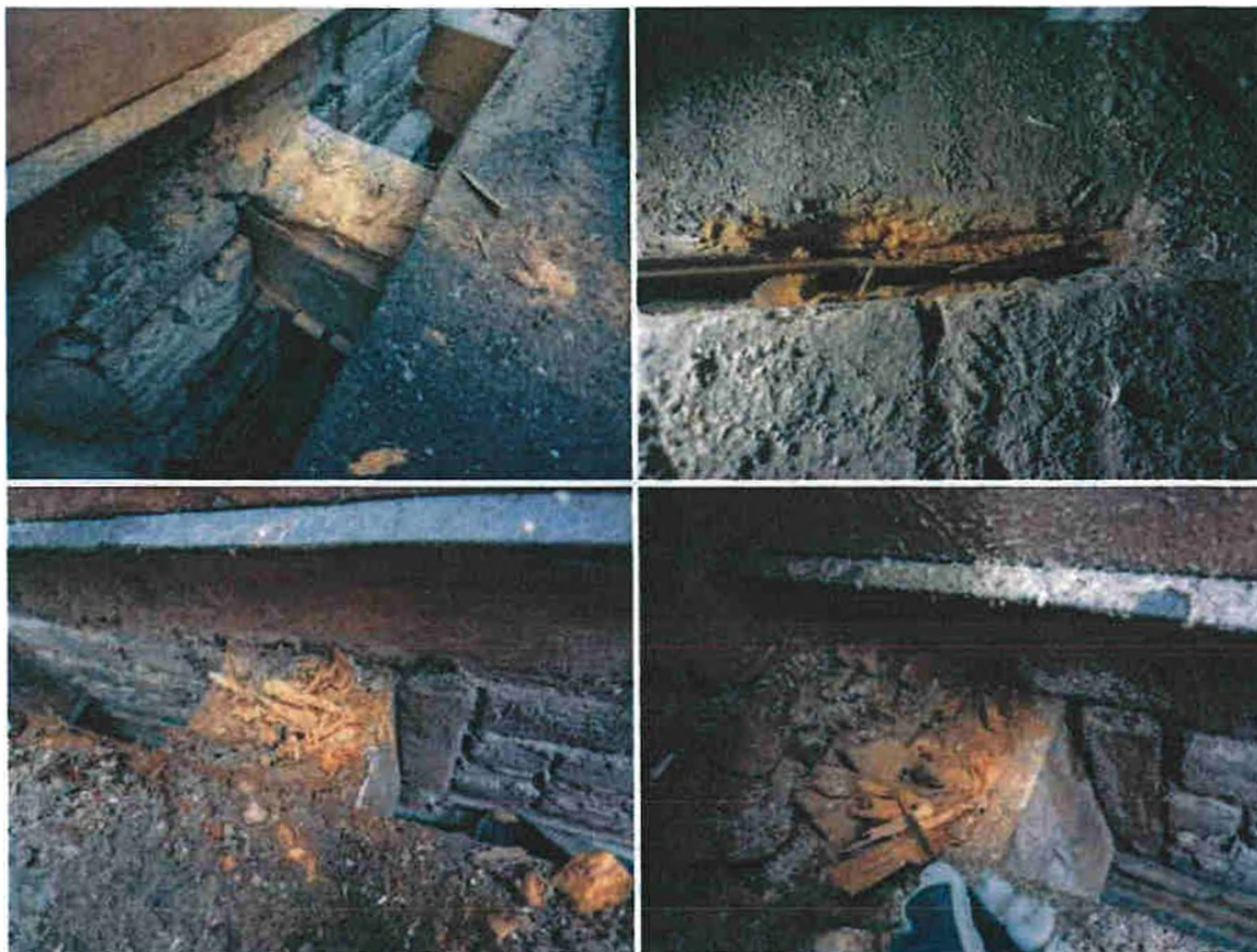
Obr. 3 Fotodokumentace: poškození stropních trámů způsobené symbiotickým působením dřevokazných hub a dřevokazného hmyzu.
