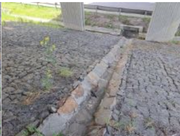
skluz odvodnění od OP1
