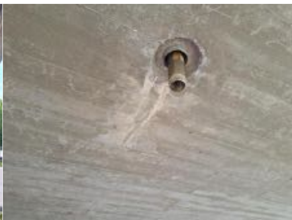
odvodňovač hydroizolace_vápenné výluhy_mostní pole č. 4
