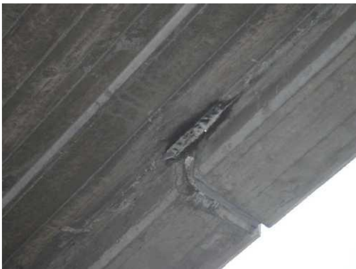
Průsak dilatací říms.
