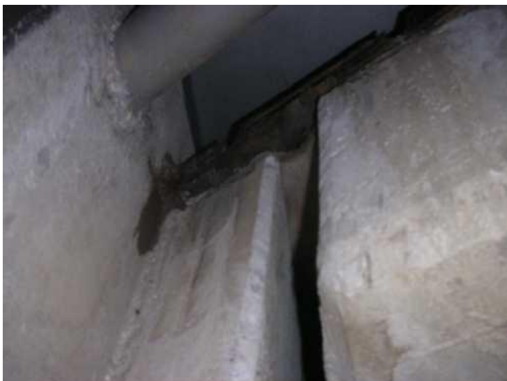
Průsak v místě dilatace na konci mostu vlevo.
