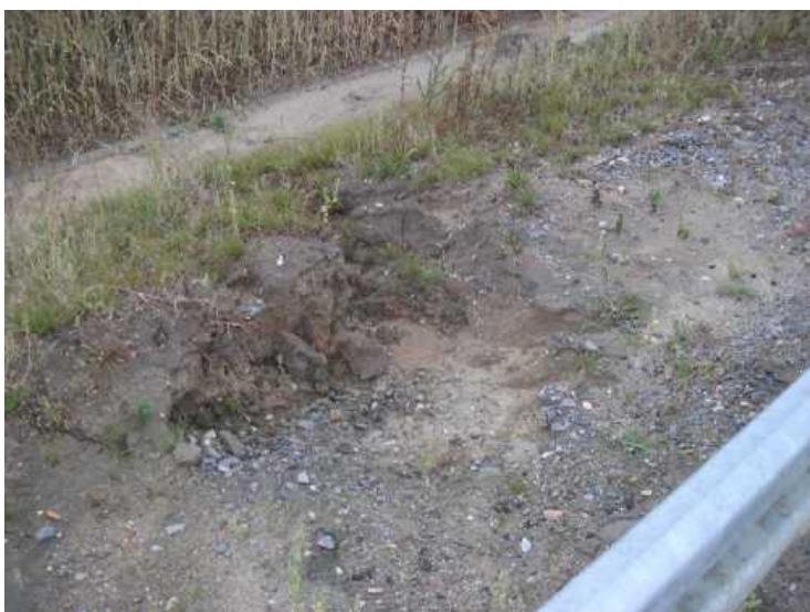
Eroze svahu na konci mostu vlevo.
