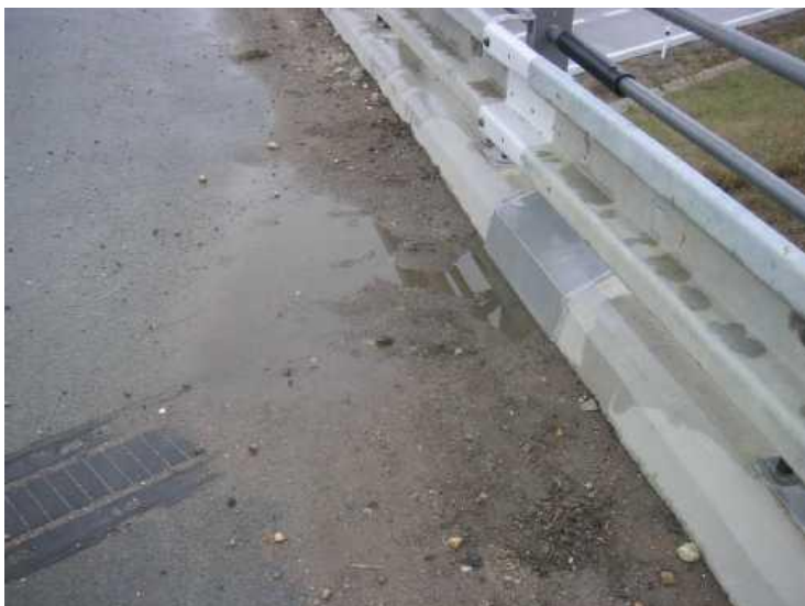
Kaluž v místě dilatace na konci mostu vlevo.
