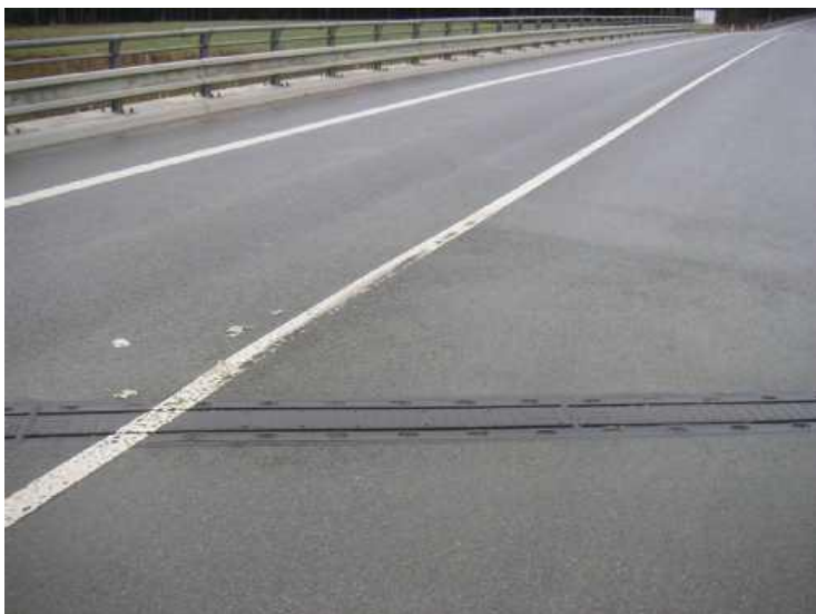
Nedostatek pojiva krytu komunikace na konci mostu.
