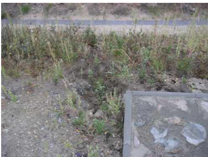
Eroze svahu na konci mostu vpravo.
