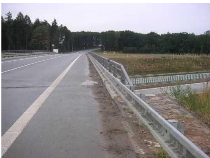
Nečistoty na krajnici na konci mostu vlevo.
