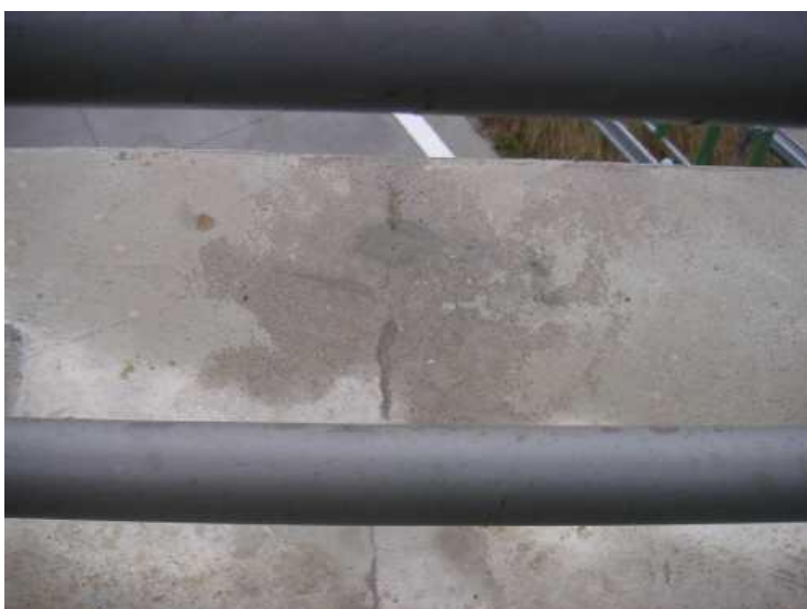
Smršťovací trhliny říms.
