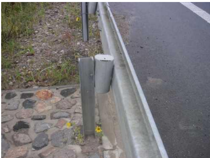
Poškozené svodidlo před mostem vpravo.
