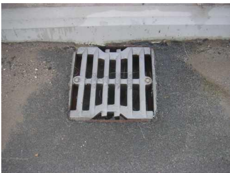
Chybí zálivky podél odvodňovačů.
