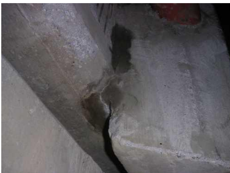
Průsak v místě dilatace na začátku mostu vpravo.
