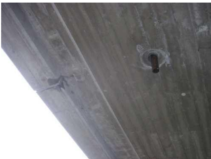
Průsaky dilatacemi říms.
