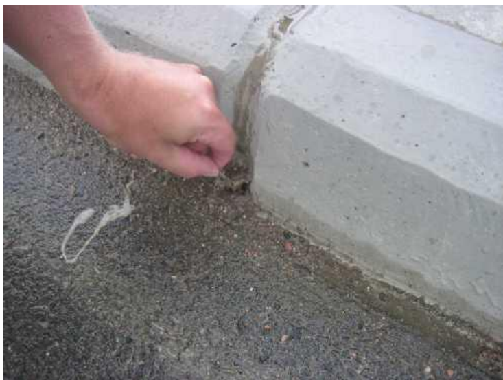
Neprojojená zálivka a tmel dilatace říms.
