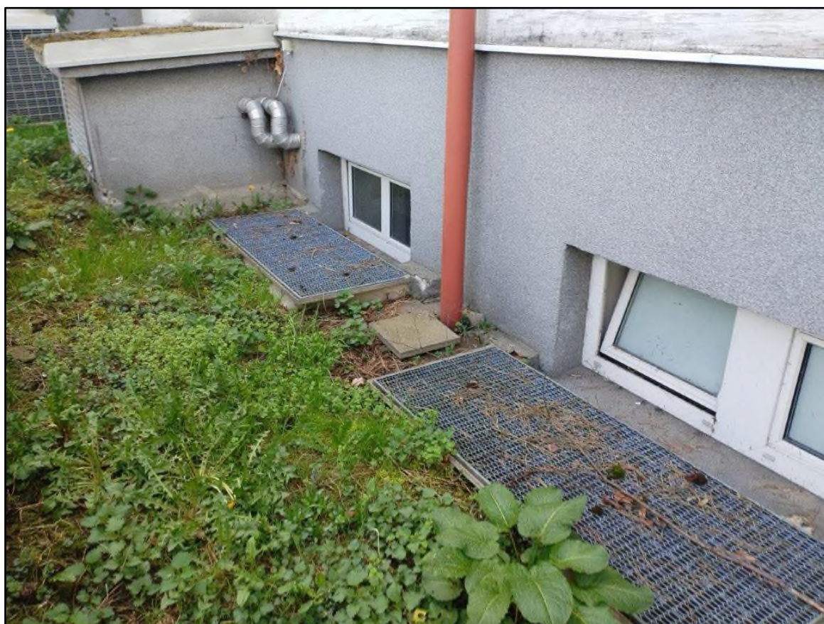
Venkovní pohled – zavlhlá stěna
