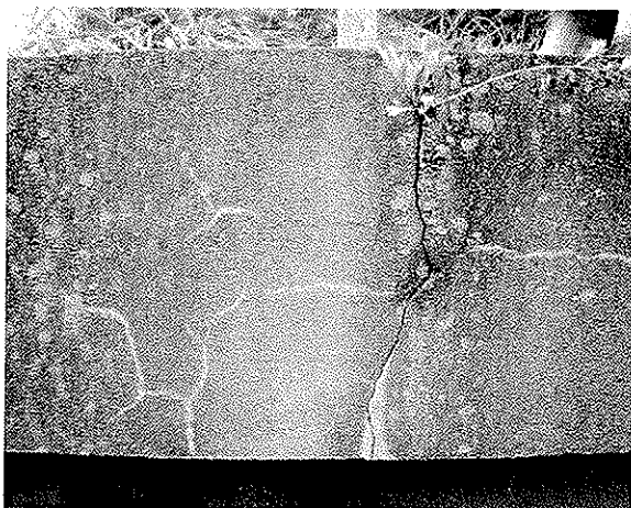
svislá trhlina v římse vpravo
