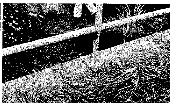
překorodované zábradlí vpravo
