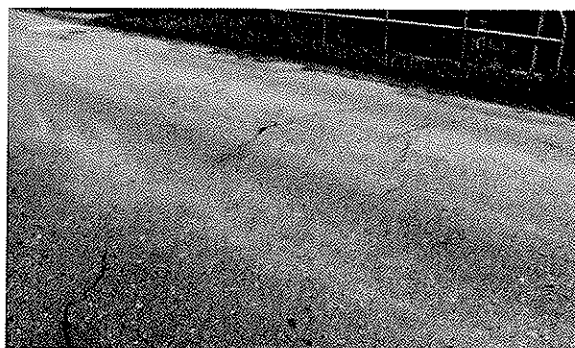
příčné praskliny v živičném krytu vozovky
