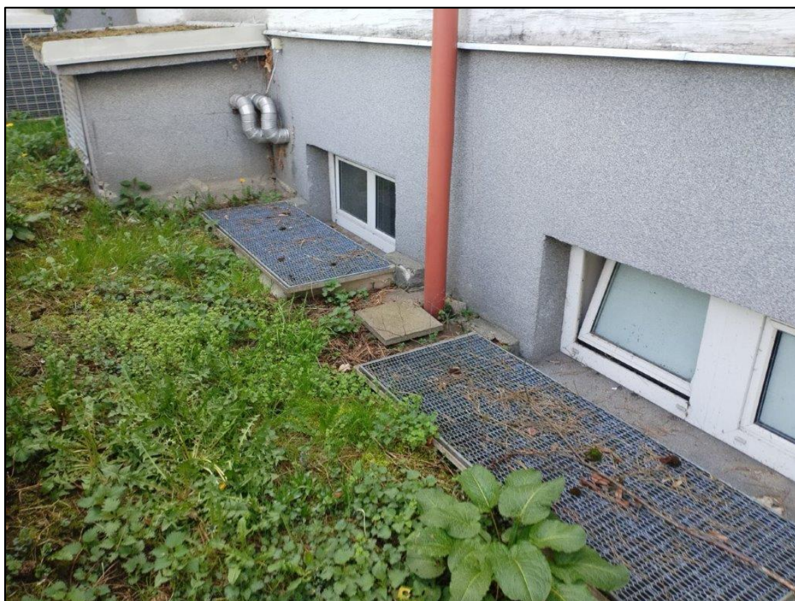
Venkovní pohled – zavlhlá stěna
