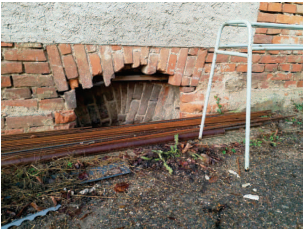
DEGRADOVANÁ VNĚJŠÍ ČÁST PŘEKladU – SANOVAT NEBO NAHRADIT
