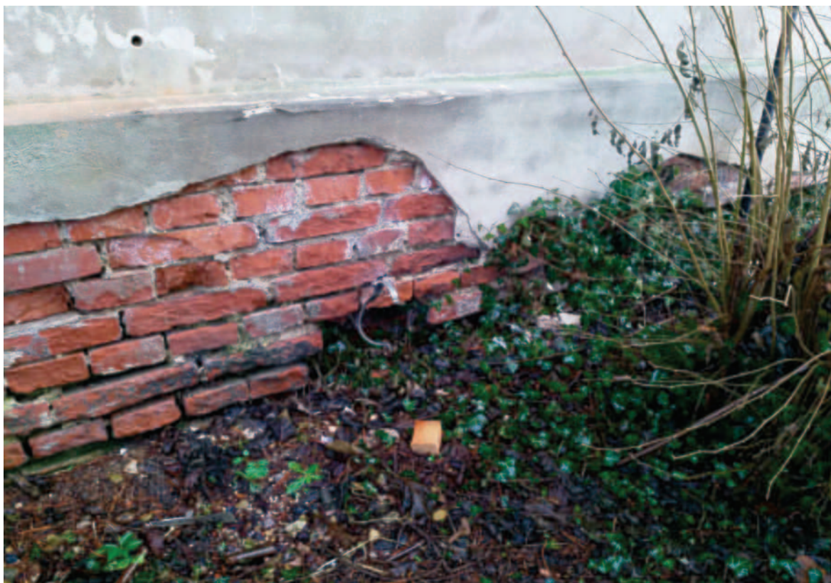
DEGRADOVANÉ ZDIVO POD ÚROVNÍ BUDOUCÍ IZOLACE
