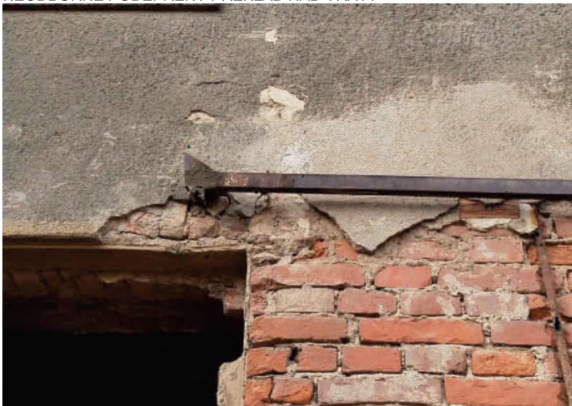
NEODBORNĚ UKOTVENÍ POJEZDU STÁVAJÍCÍCH VRAT
