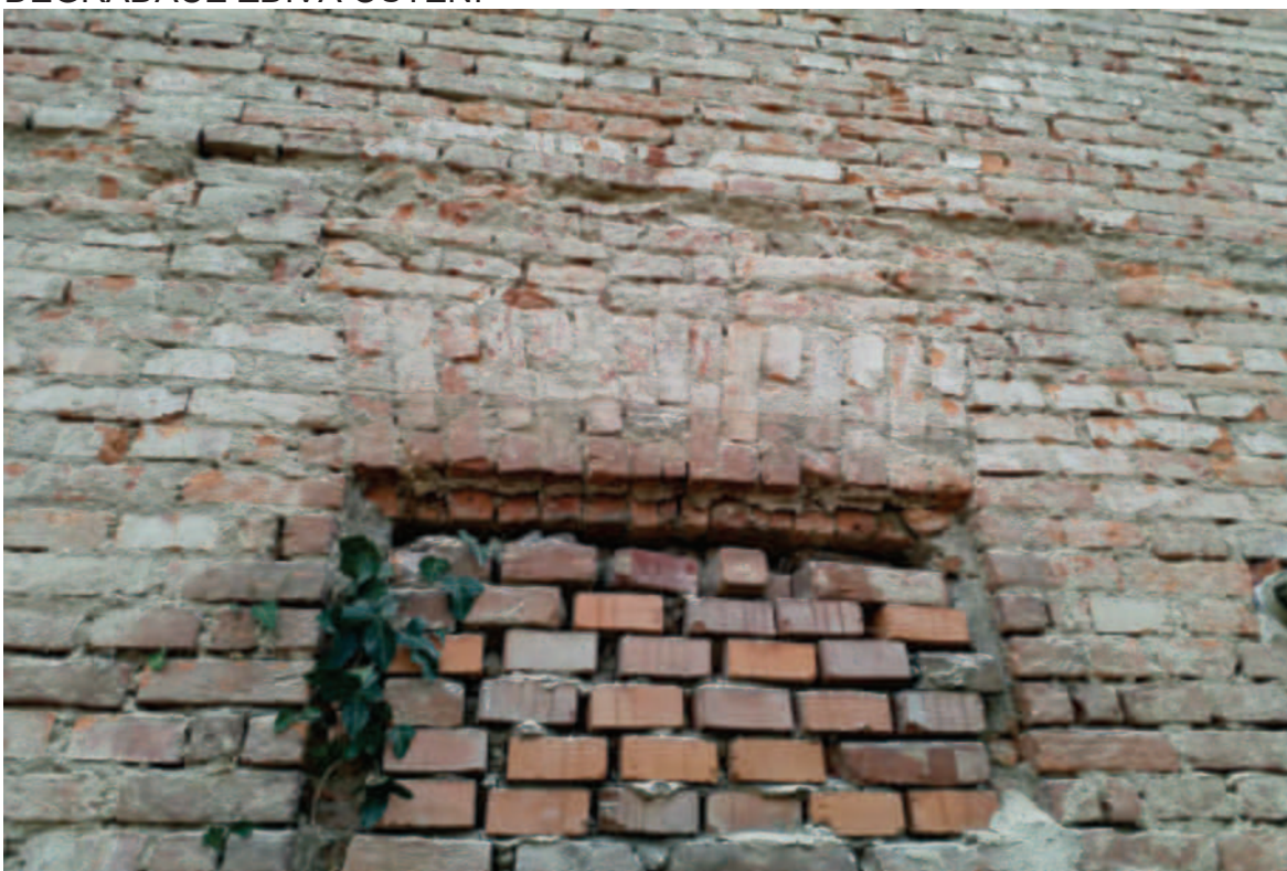
NEDEGRADOVANÝ NADOKENNÍ PŘEKLAD
