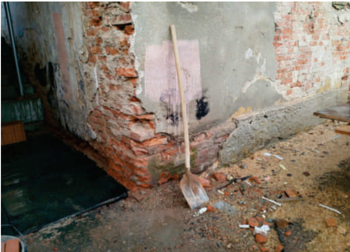
DEGRADACE ZDIVA OSTĚNÍ
