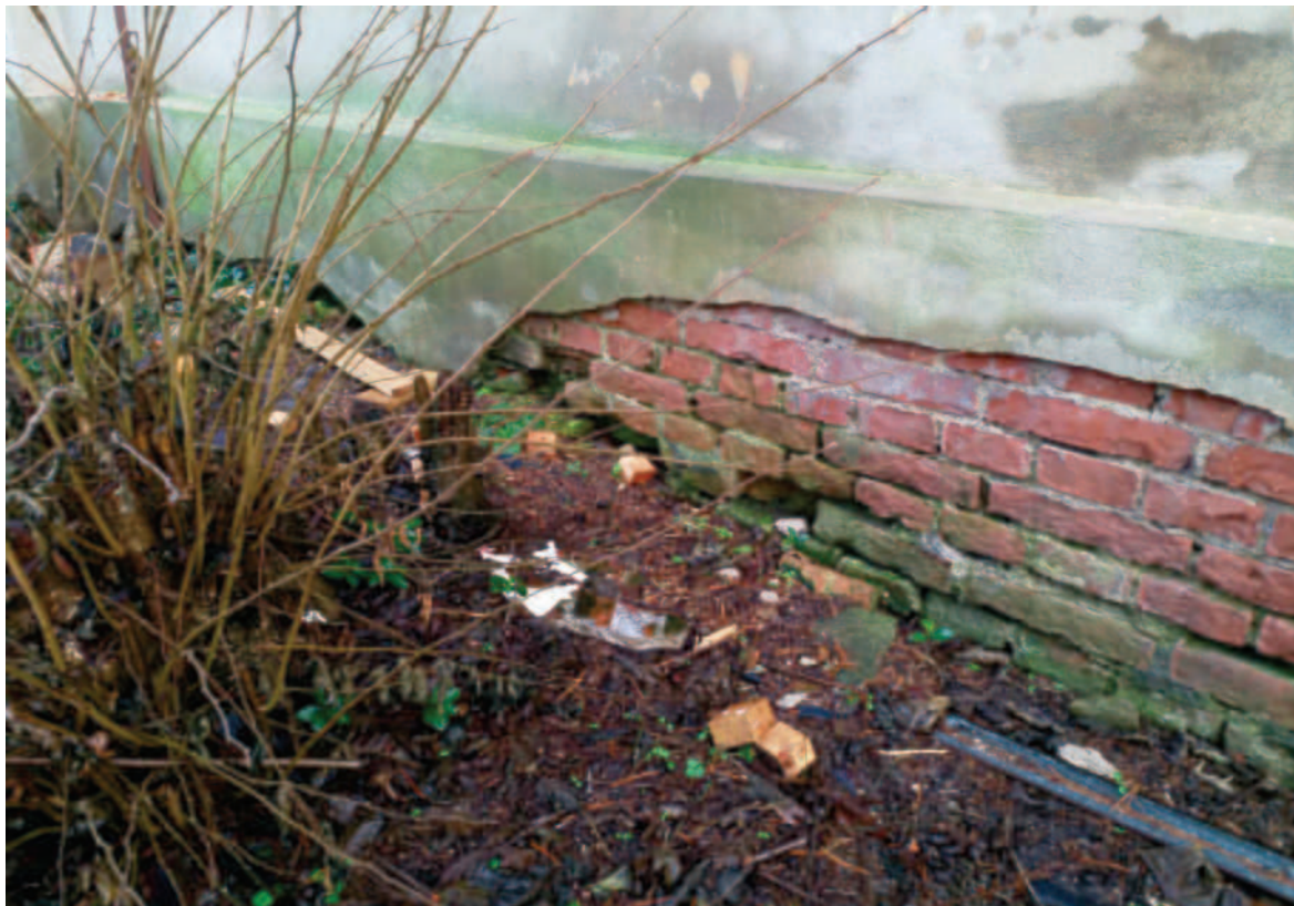
DEGRADOVANÉ ZDIVO POD ÚROVNÍ BUDOUCÍ IZOLACE
