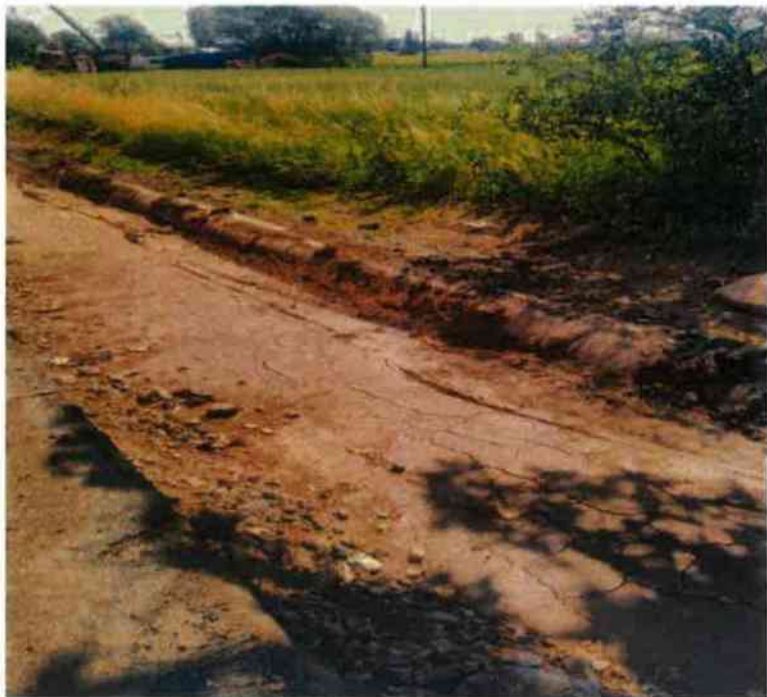
Nalezené stávající nefunkční podélné propustky v úrovni paraplaně
