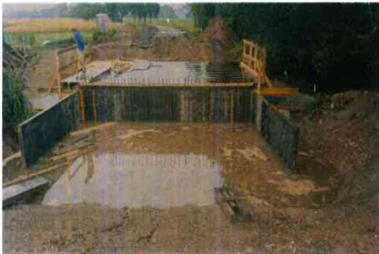
Zaplavení stavební jámy po vydatných deštích a přerušení prací
