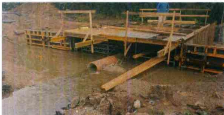
Zaplavení stavební jámy po vydatných deštích a přerušení prací
