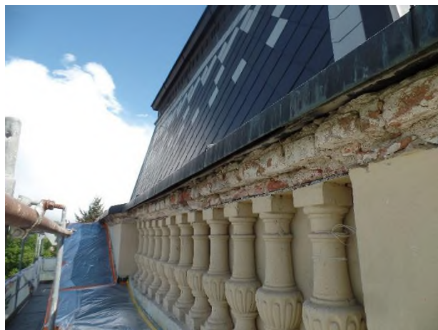
ATIKA S KUŽELKAMI - POŠKOZENÍ
