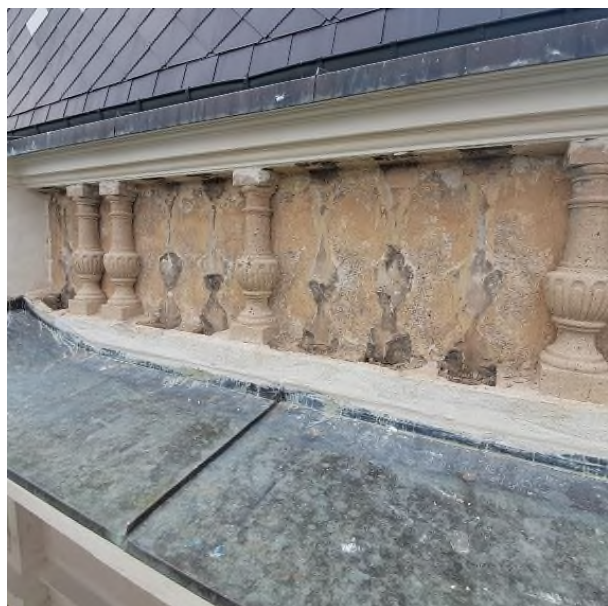
ATIKA S KUŽELKAMI – POŠKOZENÍ
