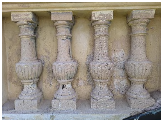
ATIKA S KUŽELKAMI – POŠKOZENÍ
