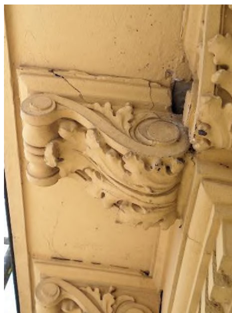
HLAVNÍ KORUNOVÁ ŘÍMSA SE ZDOBENÍM - POŠKOZENÍ
