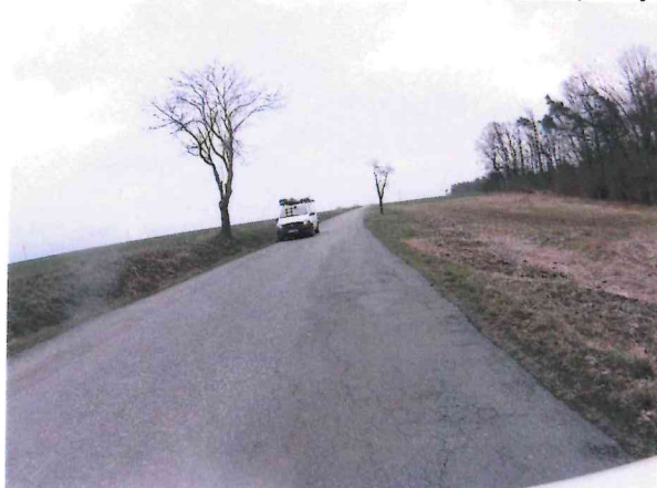
Hl. korozí, mozaikové trhliny, vysprávk
