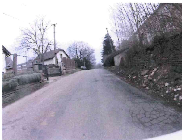
Hl. koroze, síťové trhliny až síťové trhliny, výtlučky
