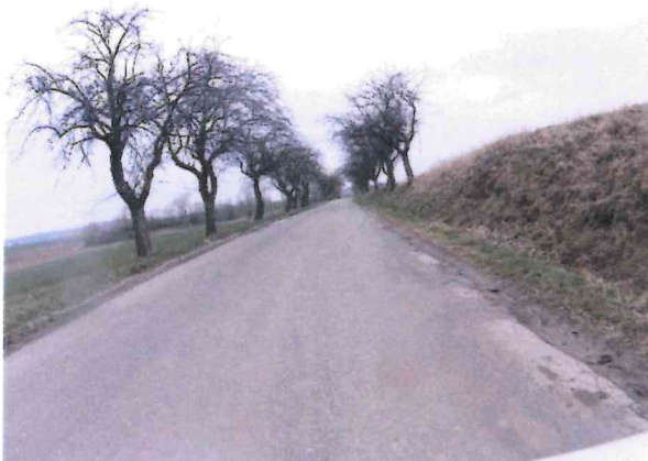
Hl. koroze, mozaikové, plošná deformace
