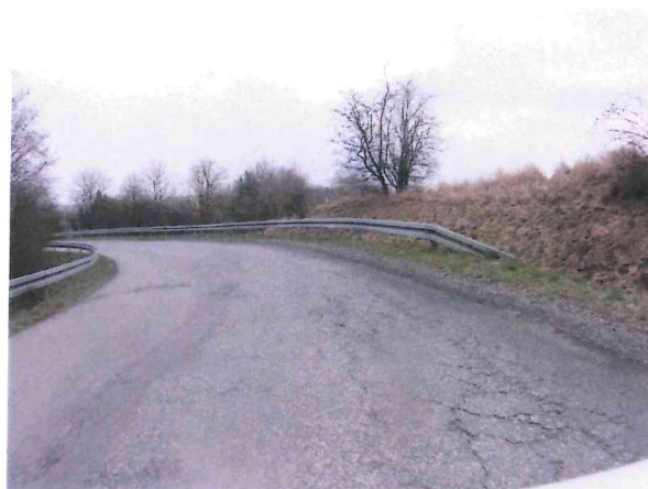
Hl. koroze, mozaikové trhliny, zvýšené nezp. krajnice
