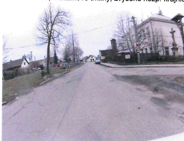
Hl. koroze, vysprávký, nepevněné krajnice, trhliny
