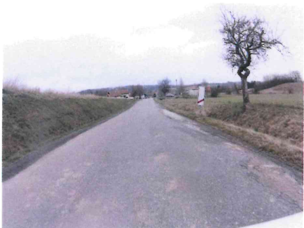
Hl. koroze, mozaikové trhliny, nepravidelné hrboly
