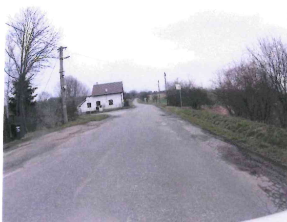
Hl. korozí, síťové trhliny, výtluky, plošná deformace
