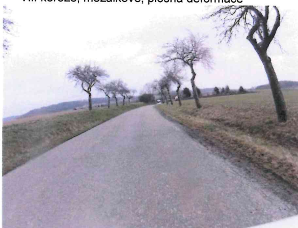
Hl. koroze, nezpevněné krajnice, mozaikové trhliny
