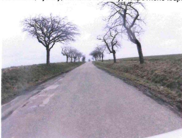
Hl. koroze, vysprávký, podélné trhliny
