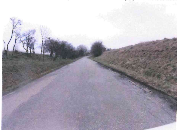
Hl. korozí, mozaikové trhliny, zvýšené nezp. krajnice
