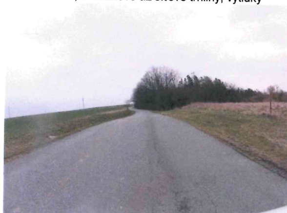
Hl. korozí, podélné trhliny a příčné trhliny
