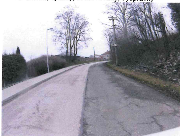
Hl. koroze, podélné a příčné trhliny, vysprávký
