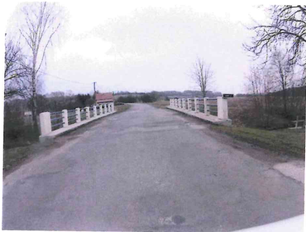
Hl. korozí, vysprávk, mozaikové trhliny, plošná deformace
