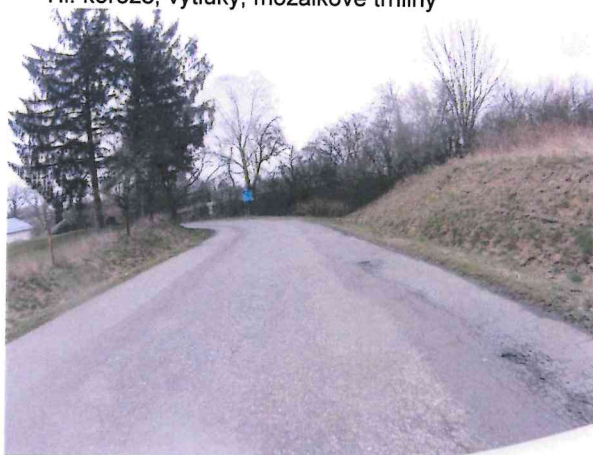
Hl. koroze, výtluky, síťové trhliny, vysprávký
