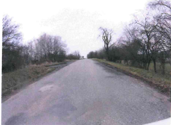
Hl. korozí, vysprávk, mozaikové trhliny, nezp. krajnice
