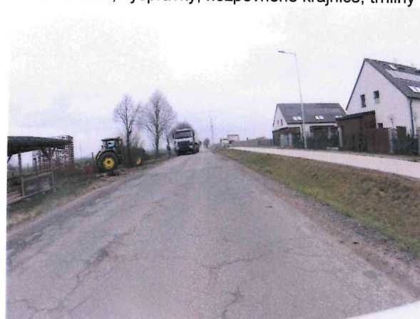
Hl. koroze, podélné rozvětvené trhliny, nezp. krajnice
