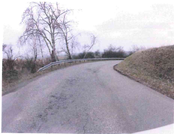
Hl. koroze, výtluky, mozaikové trhliny
