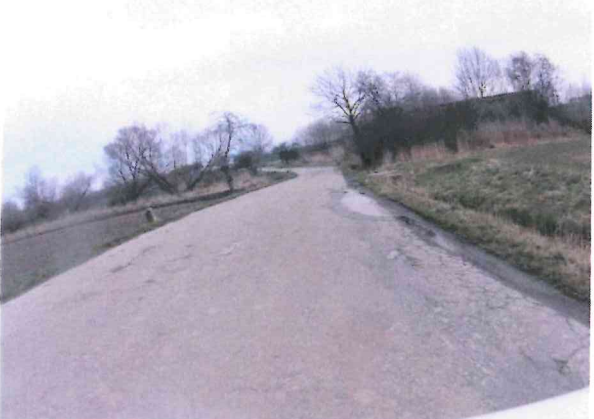
Hl. koroze, výtlučky, mozaikové trhliny, nezpevněné krajnice
