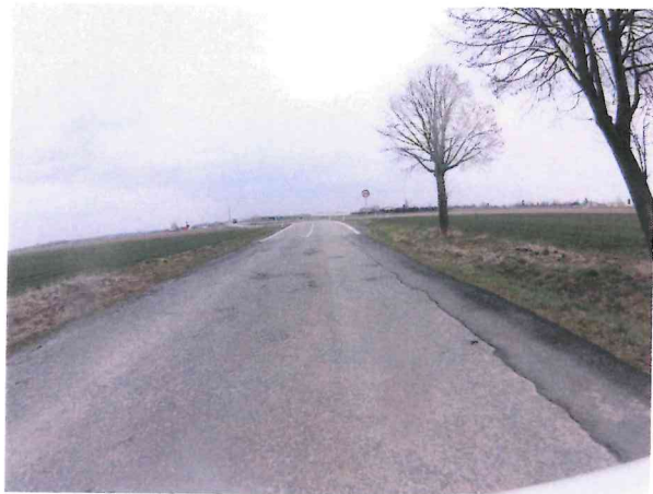
Hl. koroze, vysprávkky, mozaikové trhliny
