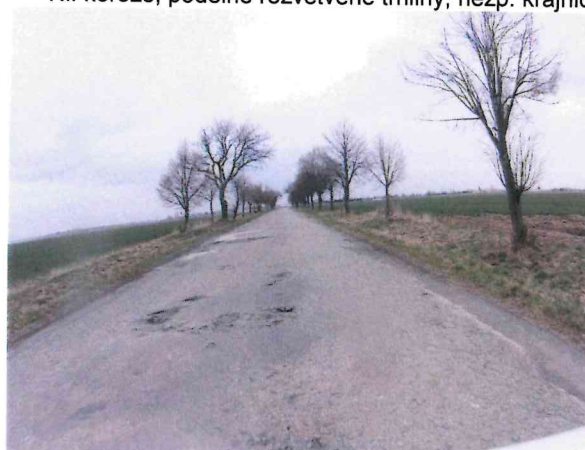
Hl. koroze, výtluky, síťové trhliny, vysprávký
