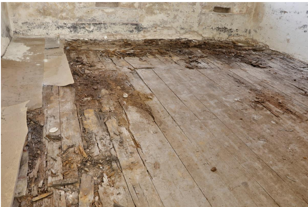
4. Prkenná podlaha jedné z místností v podzemním podlaží, těžce poškozená dřevomorkou.
