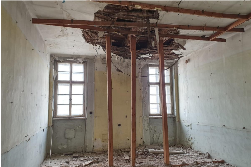
9. Havarijní stav stropu pod půdou na severní straně středního traktu, napadeného konioforou a outkovkou.
