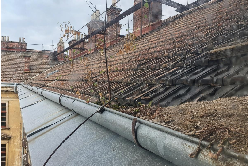
7. Špatný technický stav neudržovaných střech
