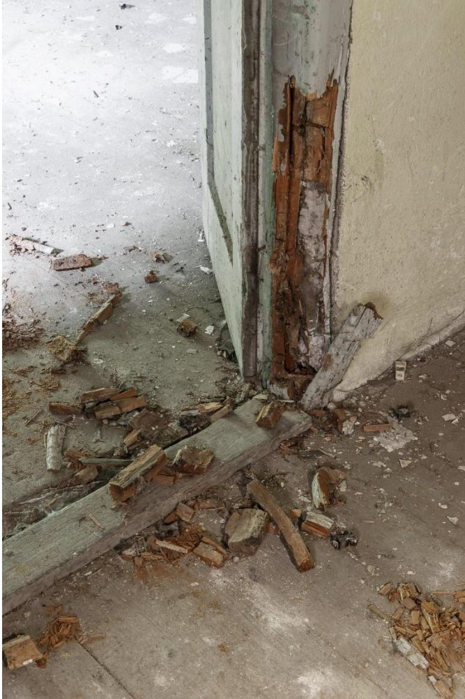
3. Dveřní zárubeň v podzemním podlaží, těžce poškozená dřevomorkou.
