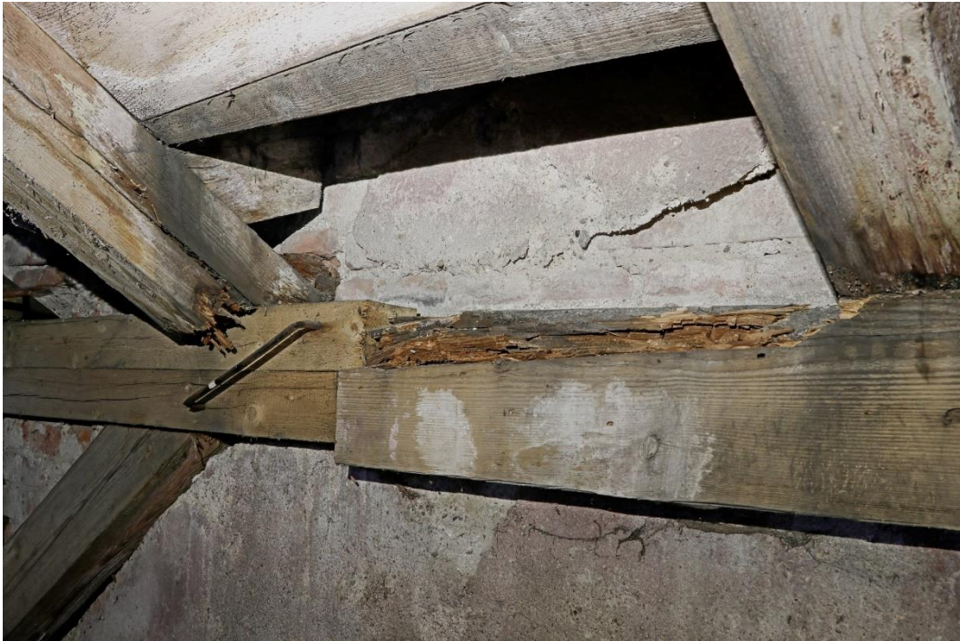
11. Pozednicová část krovu u severní atiky středního traktu, těžce poškozená konioforou a outkovkou. Část vazby krovu již v minulosti provizorně opravena nekvalitně provedenými tesařskými výměnami.
