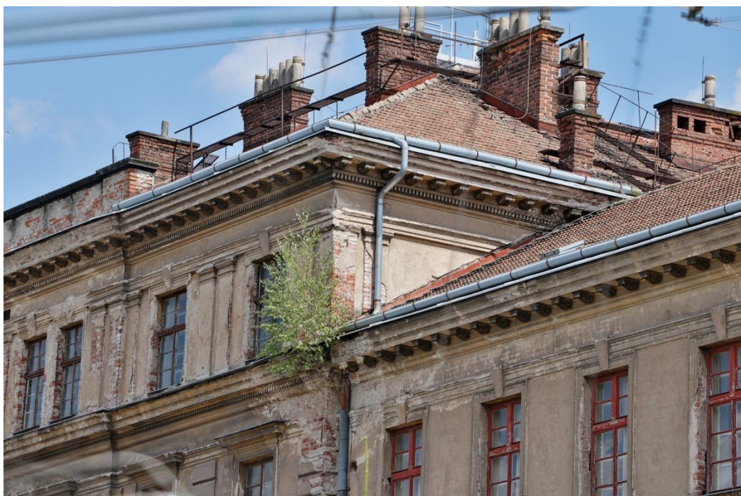
2. Střeška a zdívo středního traktu na západní straně s patrnými místy masivního dlouhodobého zatékání
