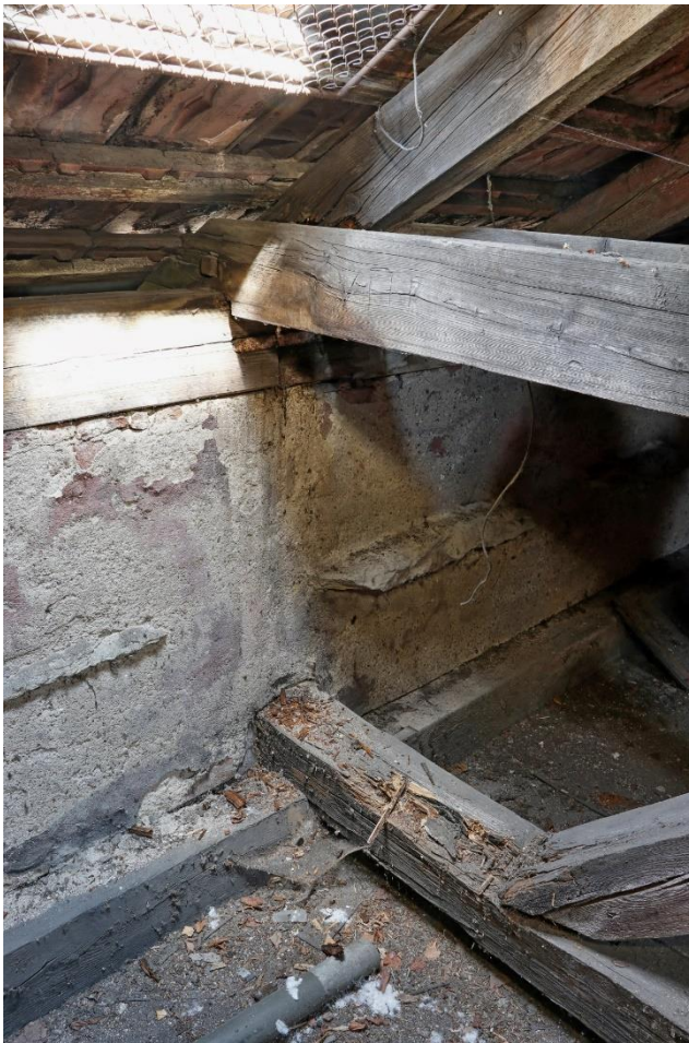
15. Pozednicová část krovu severního křídla silně poškozená kornatcem.
