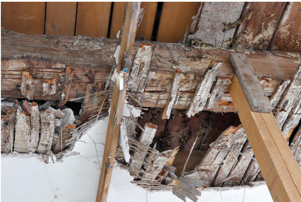
10. Detail napadení stropních trámů dřevokaznými houbami z předchozího snímku.
