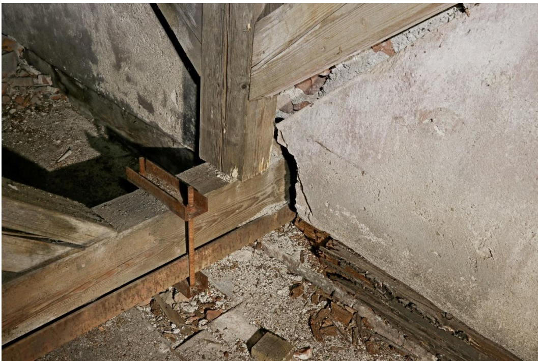
12. Část vyměněné vazby z předchozího snímku s ponechaným shnilým podkladním trámem.
