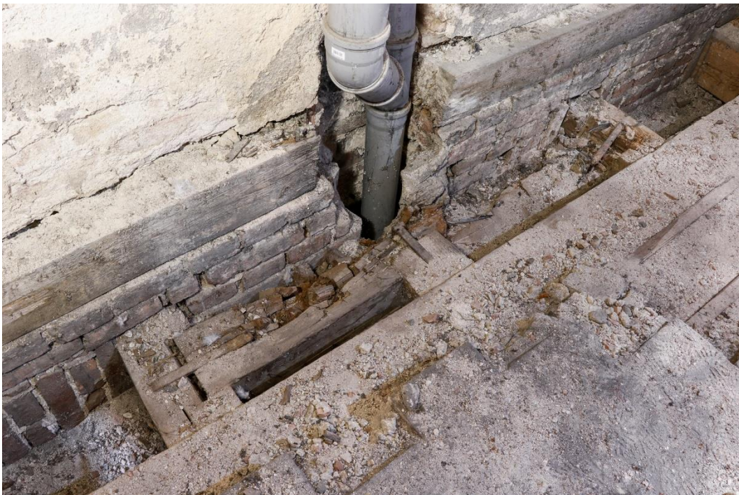
8. Havarijní stav stropu pod půdou středního traktu na jižní straně, napadeného dřevomorkou v místě masivního zatékání kolem vnitřního odtoku dešťové vody ze střešních žlabů
