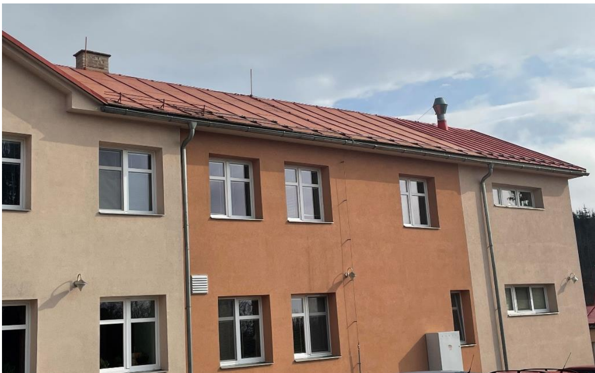
Obrázek 9 Detailnější pohled na střechu objektu D v areálu Domova na Stříbrném Vrchu Zdroj: terénní šetření
